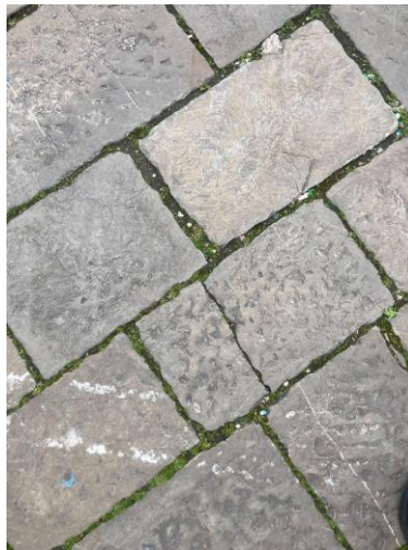
Figure 10. Permeable pavers at Piazza Santa Maria del Carmine. (Corinna Del Bianco, 2023)
